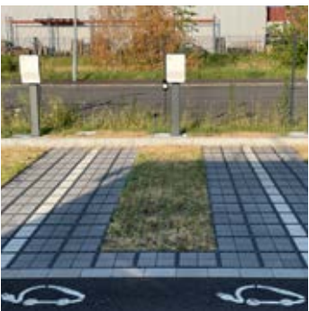
IRVE Installation de bornes de Recharge pour Véhicule Électrique
