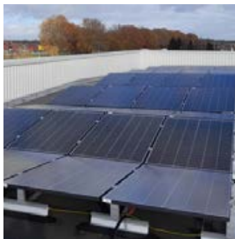
PHOTOVOLTAÏQUE Projet 207 Kwc toiture Bât. ICPE
