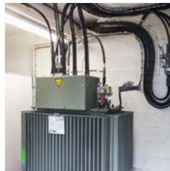
CLIENT TERTIAIRE Poste HTA/BT
